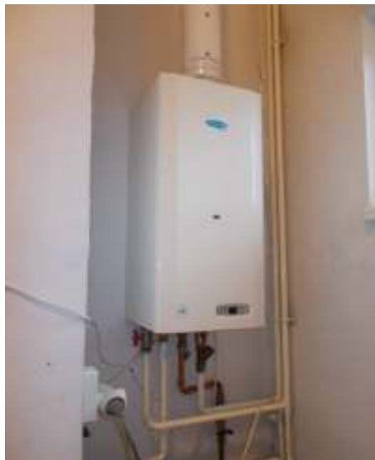
Az épület gázkazánja
