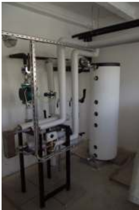
Az épület hőközpontja
