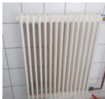
Üzemelő hűtési rendszerhez csatlakoztatott radiátor
