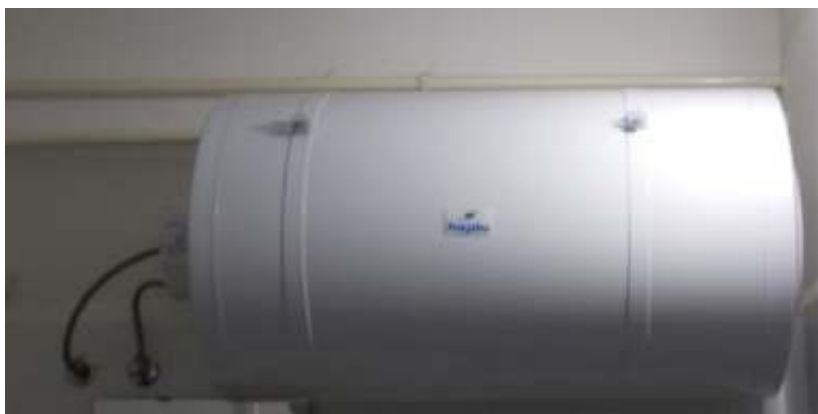
Fekvő bojler a porta épület vizes blokkjában a mennyezet alatt elhelyezve
